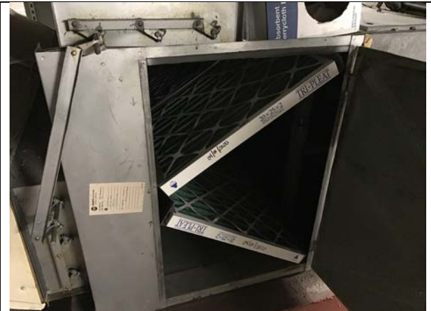
Auditorium HV Unit
