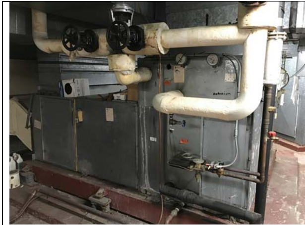
Auditorium HV Unit
