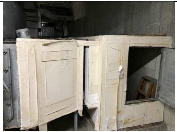
AH-1C – Mixed Air Plenum
