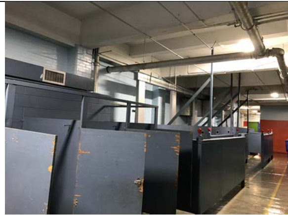
Boys Bathroom Exhaust Fan
