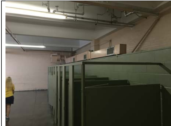
Girls Bathroom Exhaust Fan
