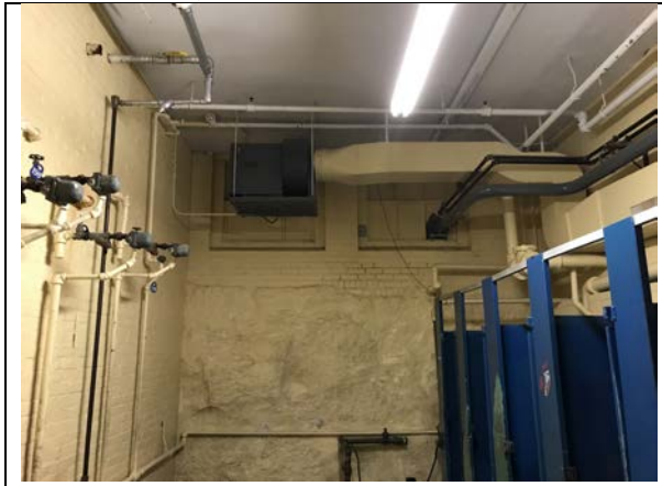
Basement Bathroom Exhaust Fan
