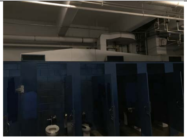
Girls Bathroom Exhaust Fan
